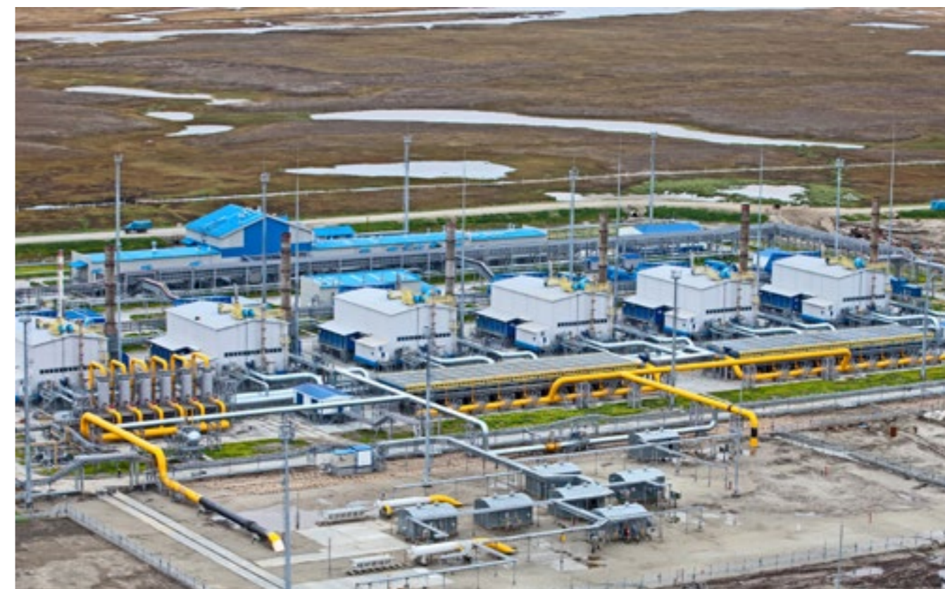
ГАЗПРОМ. Компрессорная станция «Байдарацкая» магистрального газопровода «Бованенково-Ухта»
