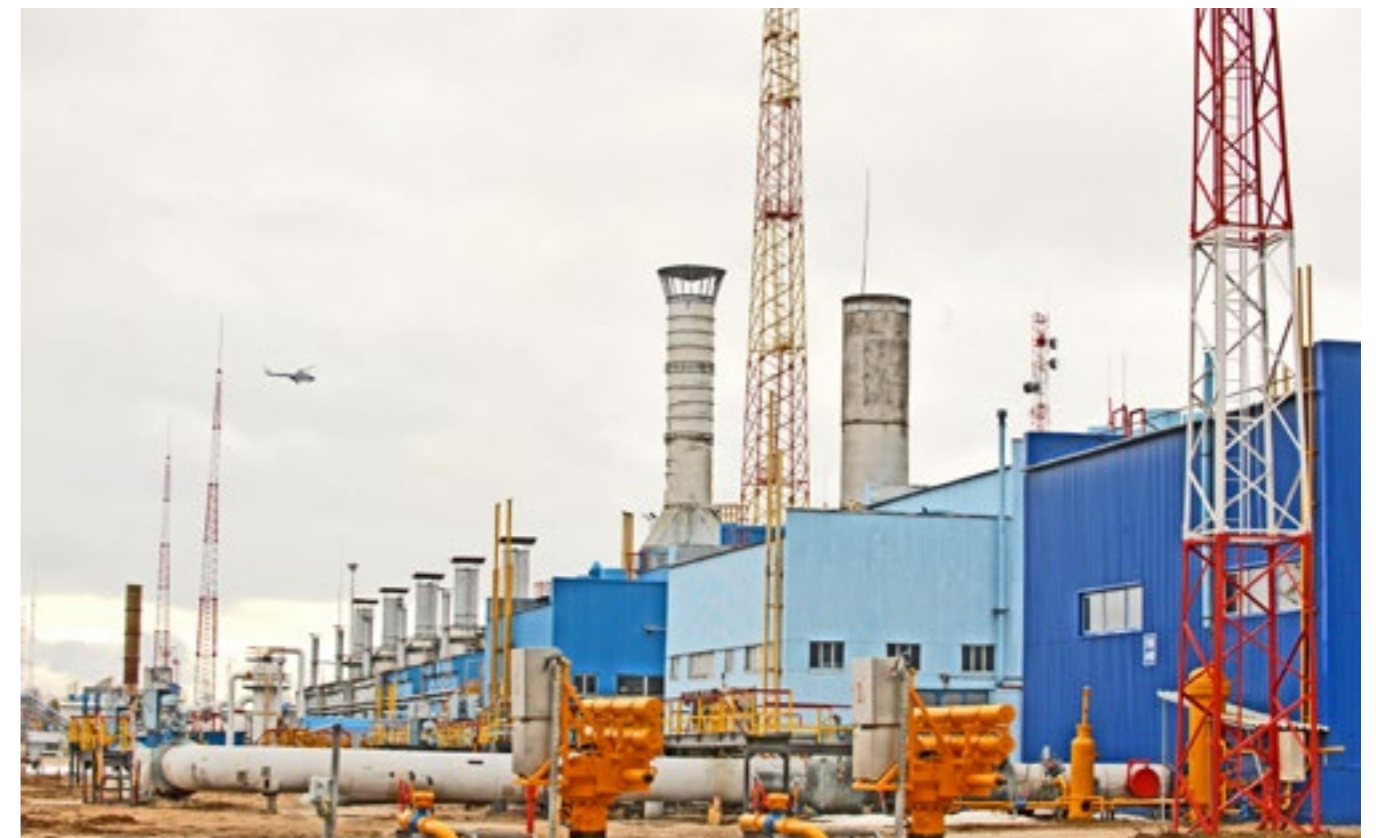
ГАЗПРОМ. Компрессорная станция «Грязовецкая» Северо-Европейского газопровода
